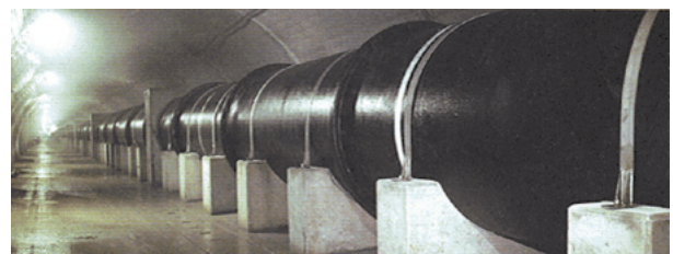
トンネル内に布設されたパイプライン
