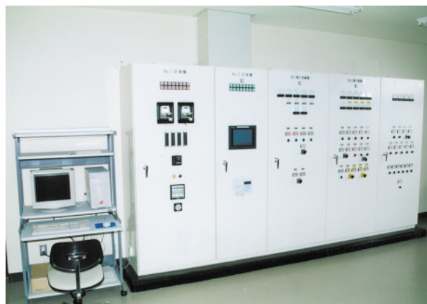
農業集落排水処理施設動力計装盤
