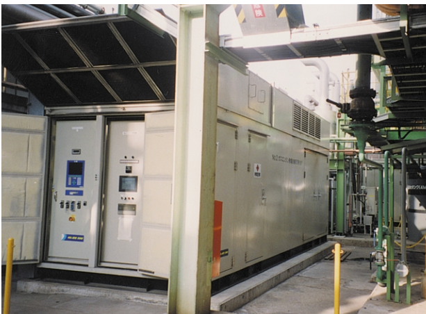
図1 コージェネレーションシステム外観 Fig. 1 Outline of cogeneration system
