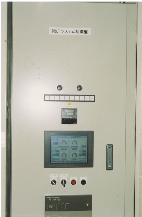
図5 システム制御盤 Fig. 5 System control board
