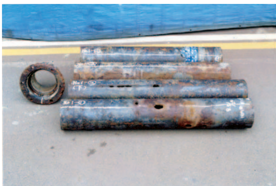
図1 腐食により漏水した管
