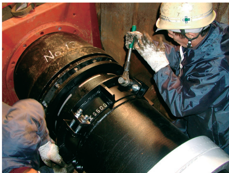
図12 サドルバンドの取付け状況 Fig.12 Attachment situation of a saddle band
