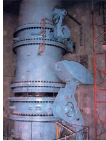
図18 φ2,400カウンタウエイト付油圧式逆止バタフライ弁据付外観
