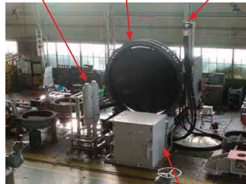
油圧ユニット 図19 φ3,500油圧式逆止バタフライ弁
