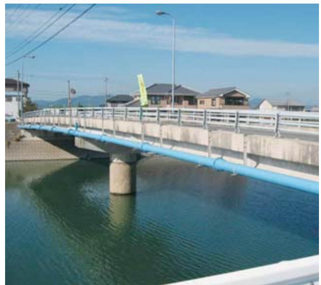
図10 φ300 SⅡ形 内面粉体塗装管 平成15年敷設
