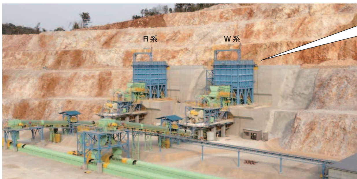
図1 プラント全景
