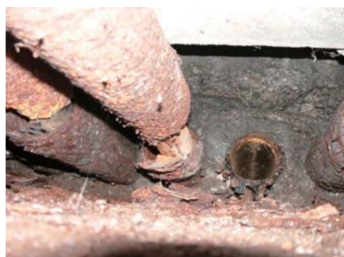
図2 金属製保護管の腐食状況
