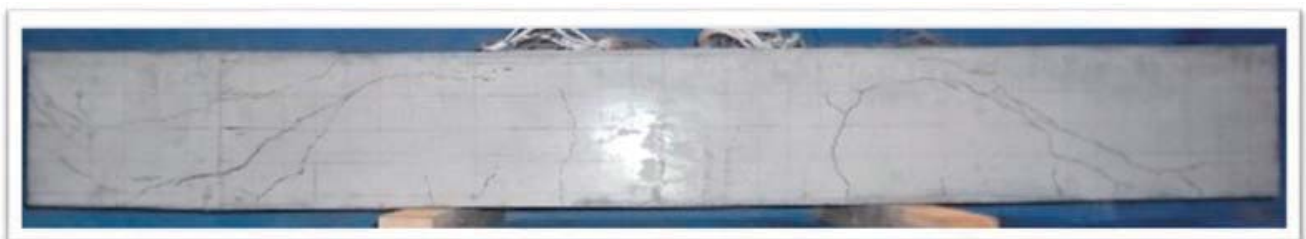
図12 ひび割れ状況
