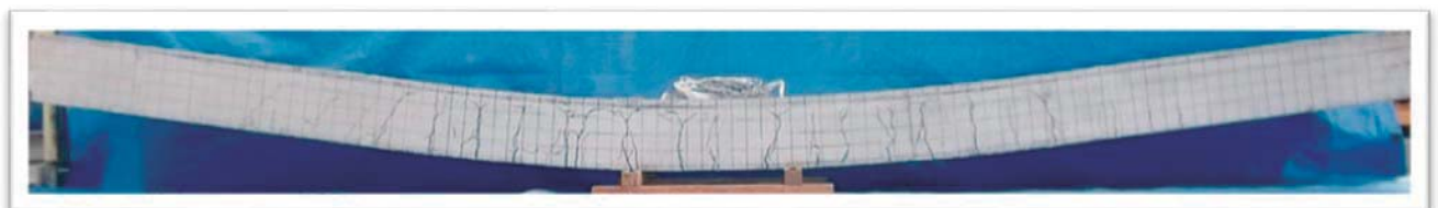
図8 ひび割れ状況
