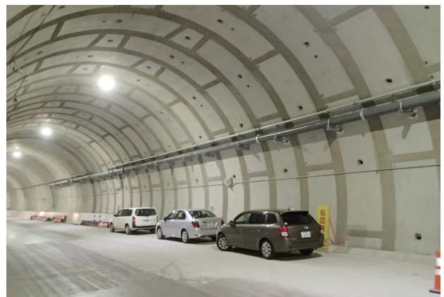
図22 トンネル壁面への添架配管状況
